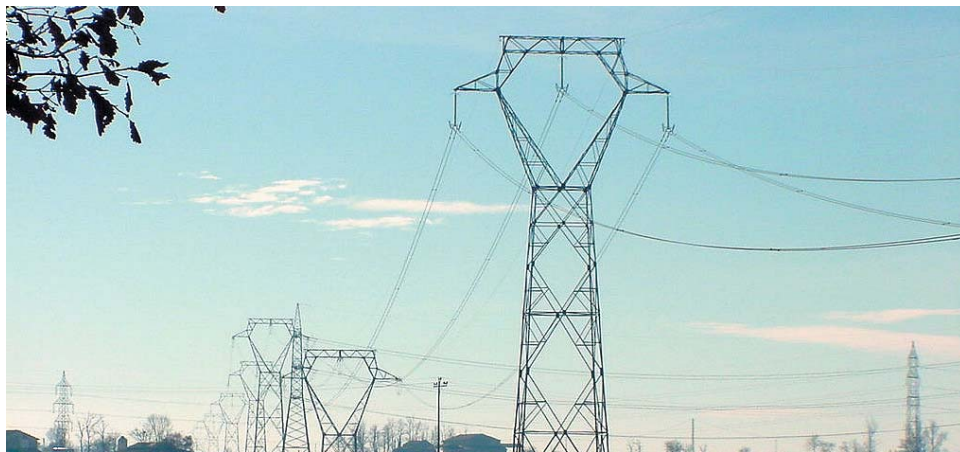
Fotografia 4. Línia A.T., 400 kV dúplex (dos fils per fase) sobre suports metàl·lics de gelosia.
