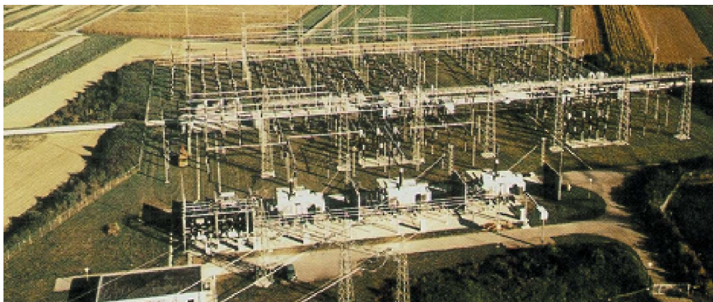
Fotografia 3. Subestació de transformació. Vista aèria.
