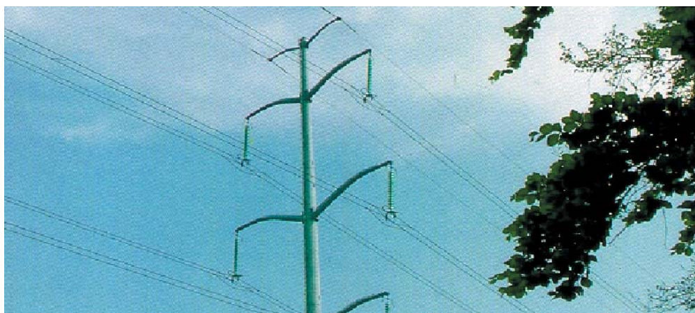
Fotografia 10. Línia elèctrica amb suport tubular.
