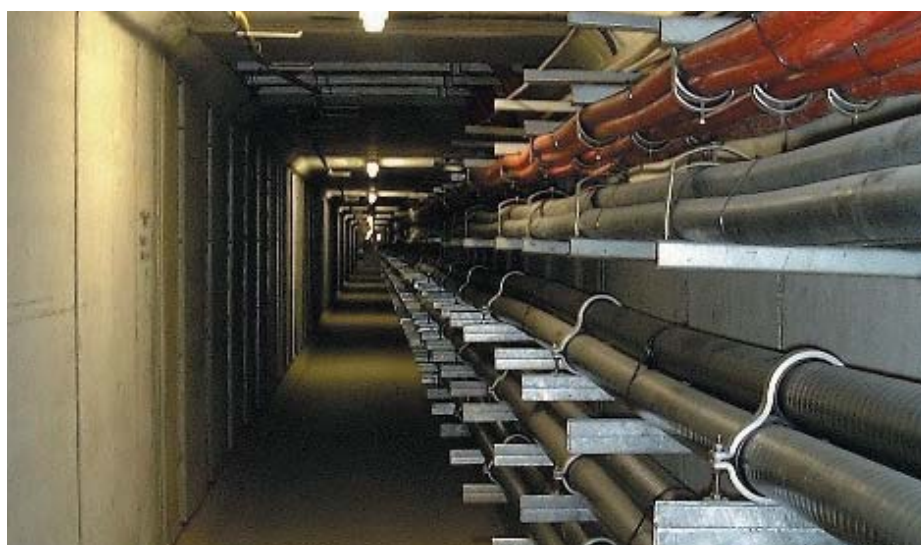
Fotografia 8. Línies elèctriques subterranies a l'interior d'una galeria de serveis
